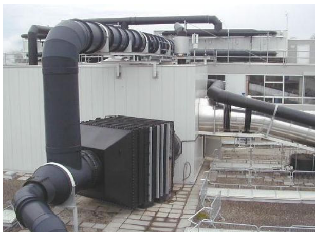
Le système d'épuration de l'air vicié dans la salle de réception des matières premières est converti à la fonction «épizootie» (soude caustique).
